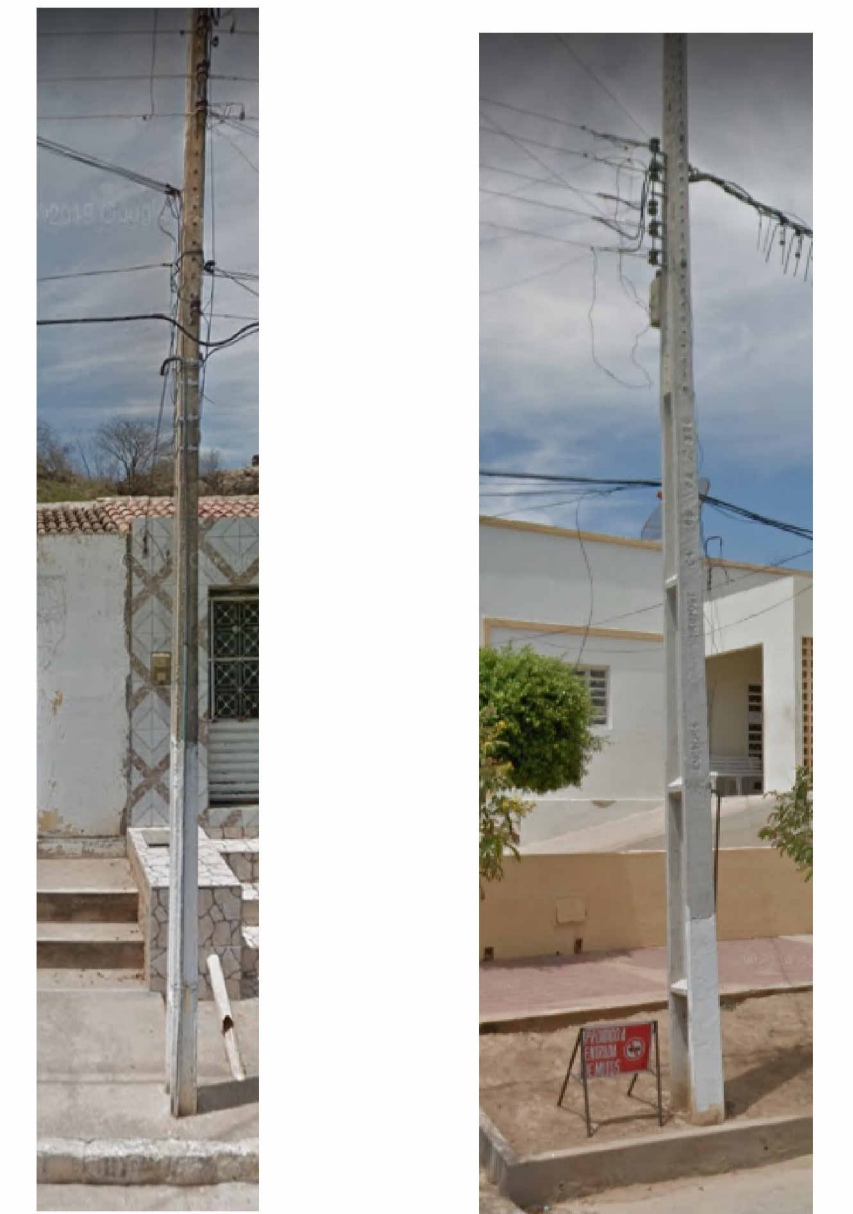
Postes de referência para entradas já existentes de energia que deverão ser readequados de acordo com padrão de entrada da ENERGISA.
